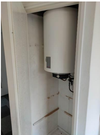
Figuur 8 boiler kast
